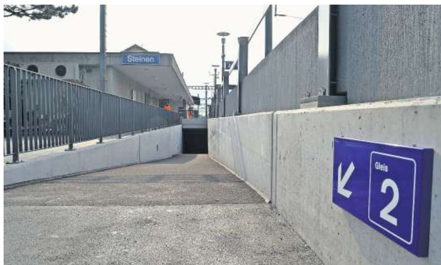
Die Unterführung auf der Dorfseite wurde komplett neu gebaut. Zum Gleis 2 kann man jetzt auch mit dem Kinderwagen fahren.
