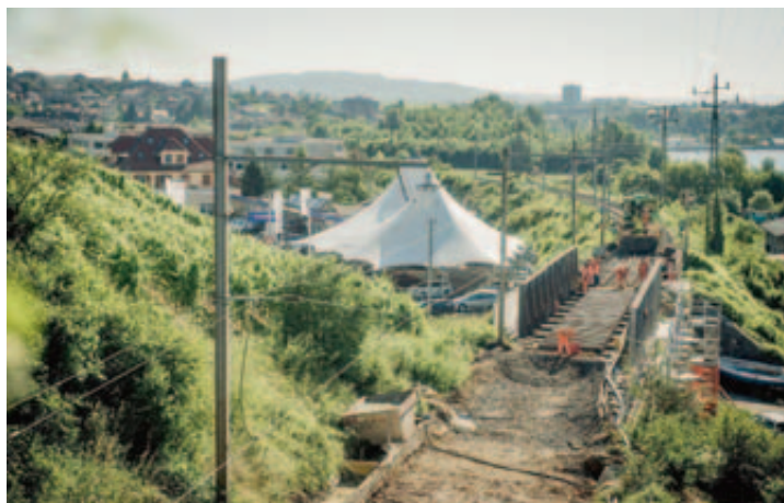
Une ligne de chemin de fer sans rails, c'est rare: sur près de 650 mètres, de part et d'autre du tunnel de Champréveyres, toute la voie a été refaite: traverses, ballast et rails. Sans parler de l'abaissement du tunnel.
