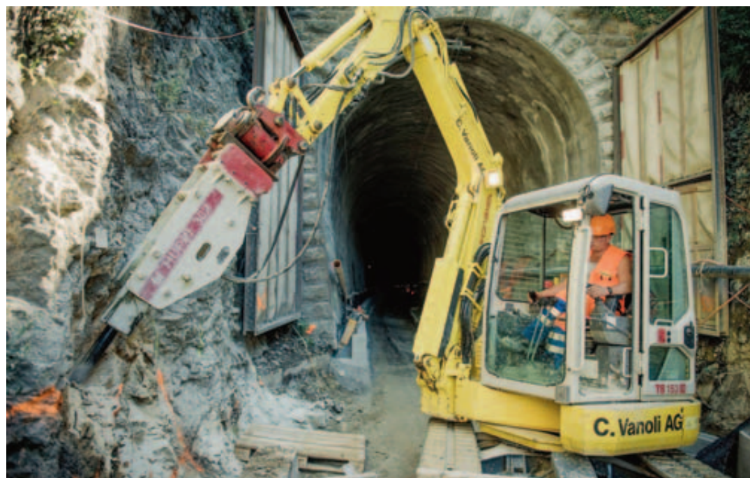
Le fond du tunnel de Champréveyres a été abaissé de 30 à 40 centimètres. Il a fallu raboter la roche, qui était très dure. De grandes portes antibruit ont été installées des deux côtés pour limiter les nuisances sonores.
