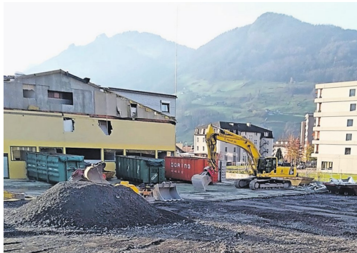
Inzwischen sind beim Tenniscenter in Ibach die Baumaschinen aufgefahren. Leserbild: David Inderbitzin
