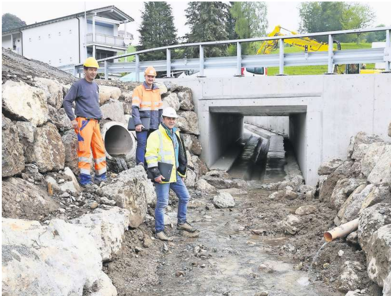
Projektleiter Heinz Herger vom Bezirk Küssnacht (Mitte) mit Vorarbeiter Armin Infanger von der C. Vanoli AG (links) und Daniel Bättig von der bsp Ingenieure + Planer AG (rechts) auf der Baustelle an der Artherstrasse.
